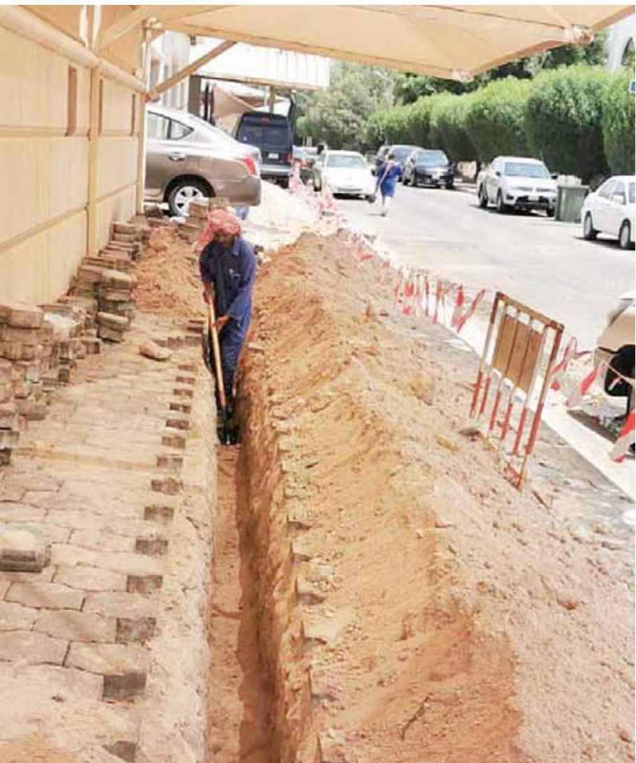
أعمال الحفر تنسيب في حصول انقطاعات للكهرباء
